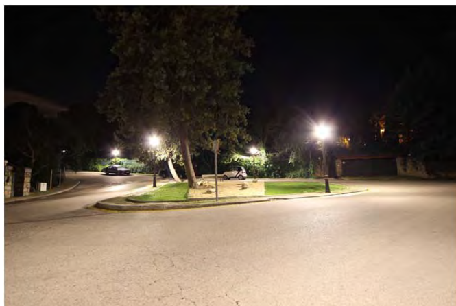
Imagen de la instalación con difusores prismáticos y óptica Type III Medium
