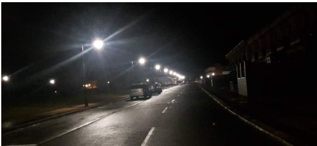
Ejemplo calle iluminada con mazorcas LED. Elevado deslumbramiento y calzada y acera derechas a oscuras.
