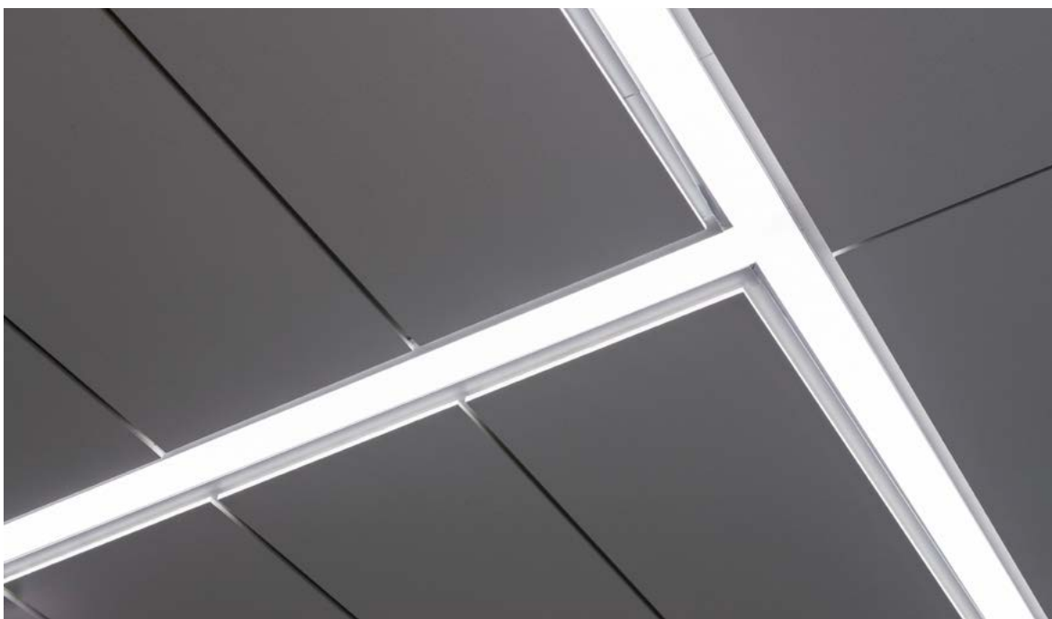
Detalle de instalación de lámparas de LED en techo de oficina. Imagen cedida por LEDS C4.
