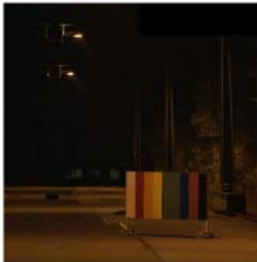
*Luminarias 250W VSAP
