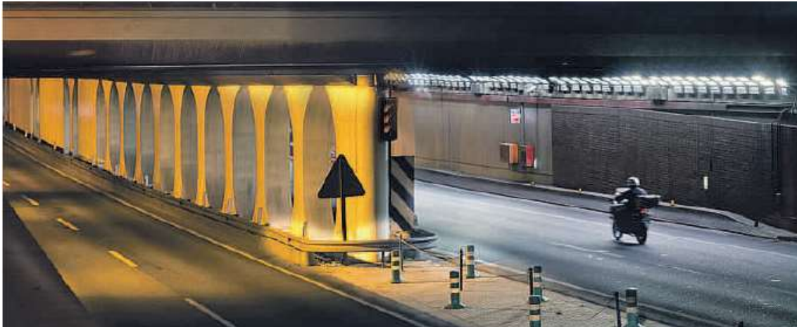
Ilustración 1. Pruebas de iluminación LED en una de las bocas del túnel (2015).
