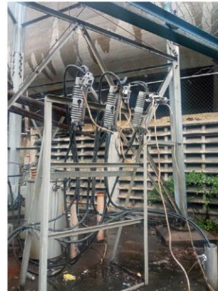
Mantenimiento del sistema eléctrico
