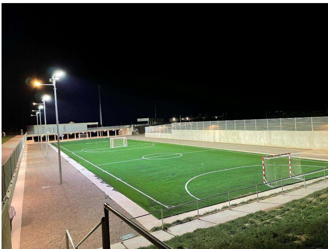
Iluminación arquitectónica en graderíos
