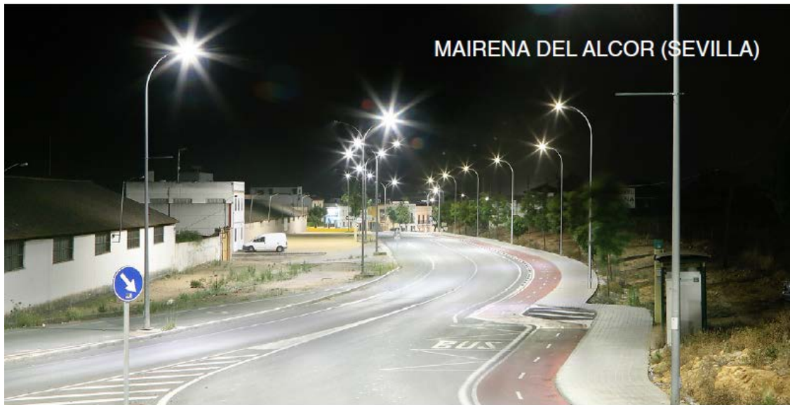
Avenida Lepanto (Mairena del Alcor, Sevilla) Nº de luminarias instaladas en Mairena: 4.842 luminarias, 58 centros de mando
