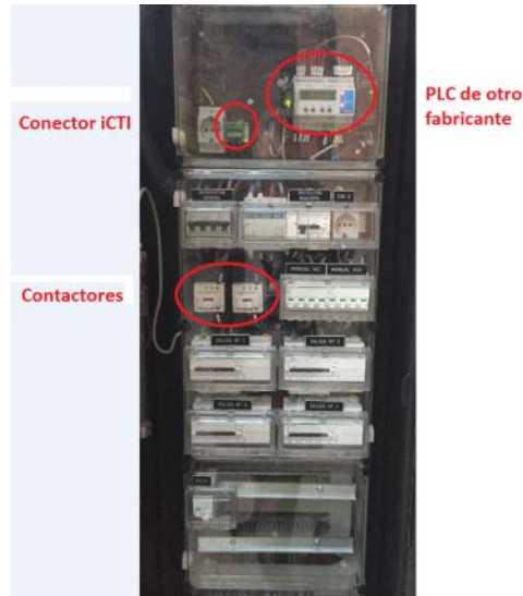
Fig. 13: Cuadro eléctrico con conector ICTI y PLC de otro fabricante
